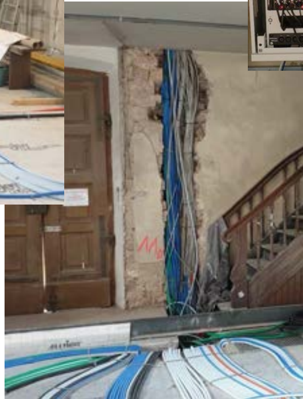
Kabelstränge Strom, Bild, Ton
