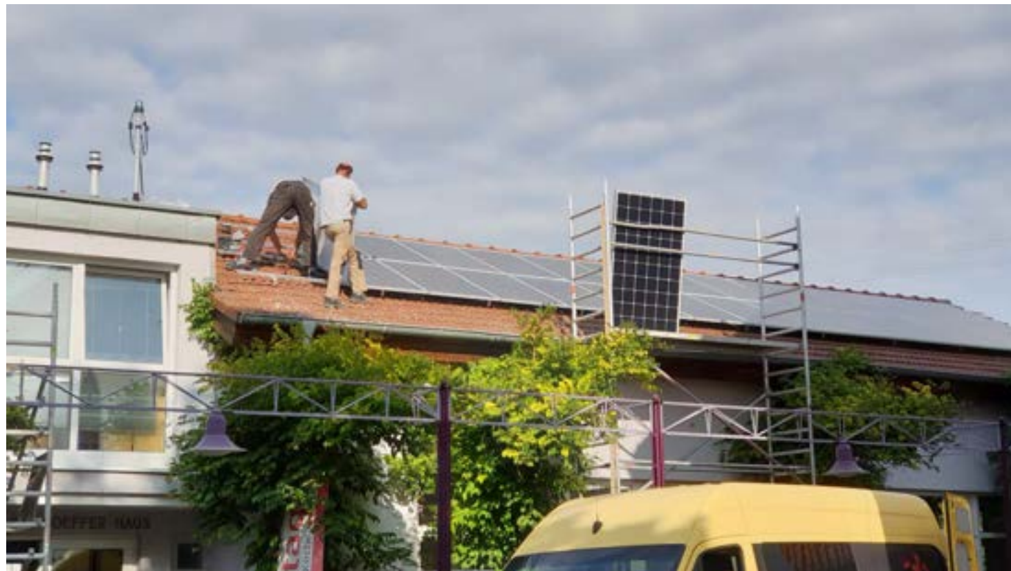
Photovoltaik-Anlage (18,36 kWp) (auf Dach des Gemeindehauses)
